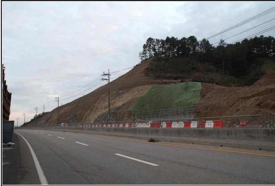
【그림 3】 깎기비탈면 시점부 측면 사진
